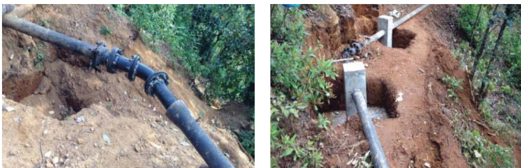
Figura 8. Tubería metálica y de PVC.
