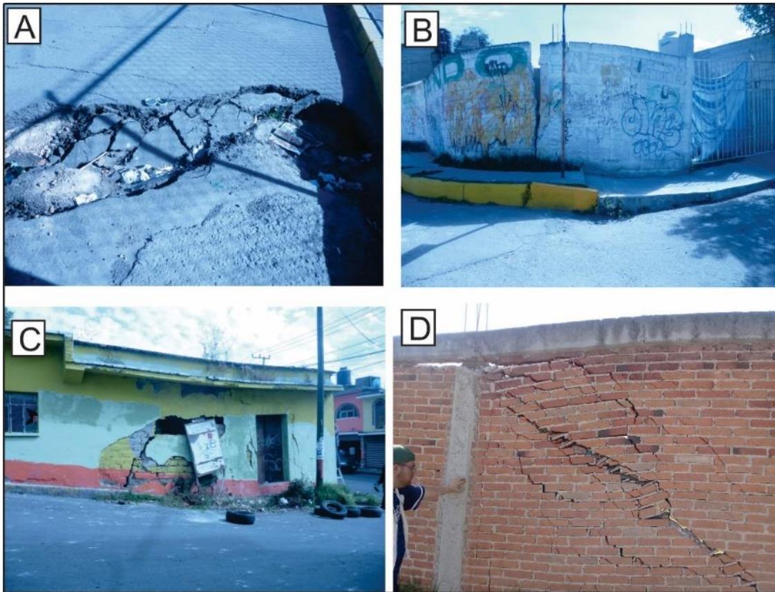
Figura 6. Geometría de grietas y fallas de subsidencia en construcciones afectadas. A, estructura sigmoideal definida por grietas y desplazamiento vertical de falla de subsidencia. B, falla de subsidencia con desplazamiento vertical, grietas de tensión ramificadas en aceras y bardas de construcción. C, construcción intensamente fracturada en zona de fallas de subsidencia de Oxtotitlán. D, fallas inversas de subsidencia en muro de construcción resultado de acomodo estructural de falla principal Totoltepec de subsidencia.
